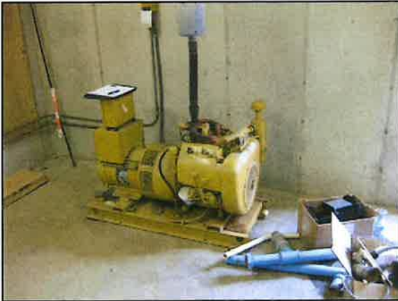
12.5 kVA Katolight Generator
